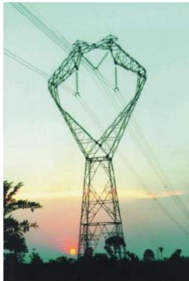
230 kV - Torre Compacta Raquete
