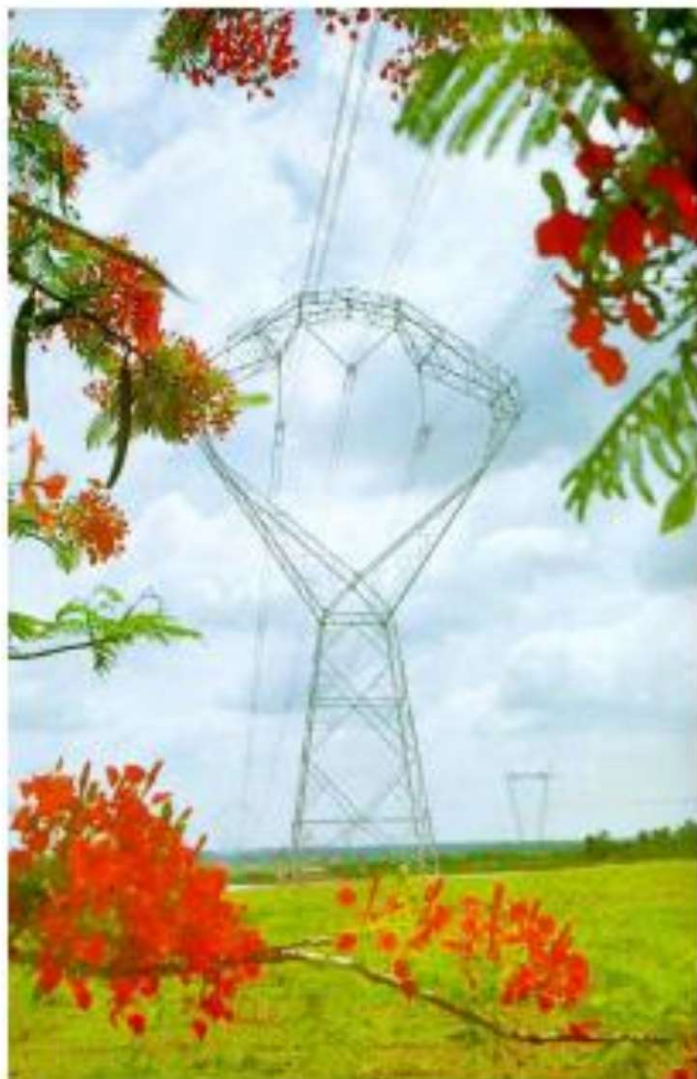
500 kV - Torre Compacta Raquete
